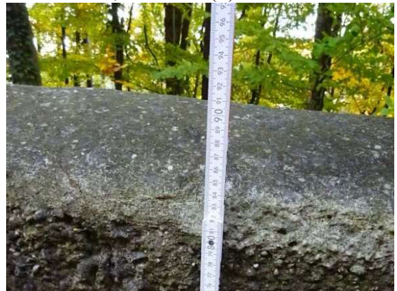
HP2021_BRÜSTUNG ZU NIEDRIG
