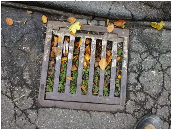
HP2021_FAHRBAHNBELAG VERWALKT UND ABGESACKT
