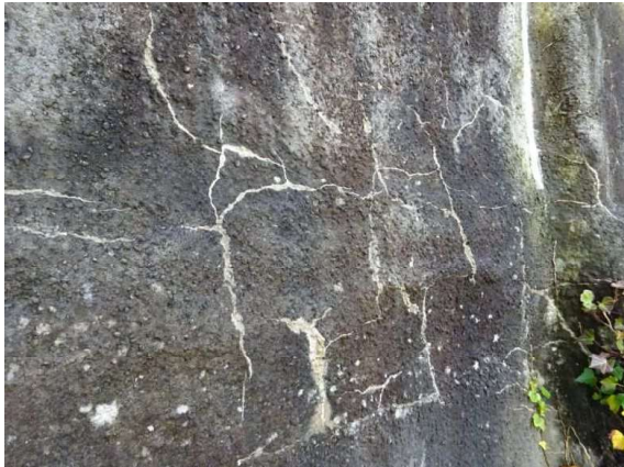
HP2021_SPRITZBETONSCHALE RISSE MIT AUSSINTERUNG
