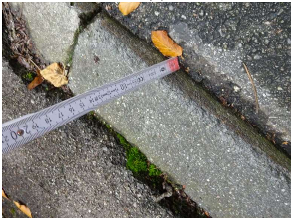
HP2021_SCHRAMMBORD ZU TIEF
