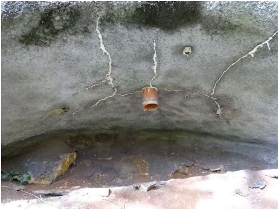
HP2021_GEWÖLBEWANDUNG RISSE MIT AUSSINTERUNGEN
