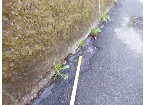
7524526_2016H_20-FUGENFÜLLUNG LÄNGSFUGE BRÜSTUNG-GEHWEG SCHADHAFT
