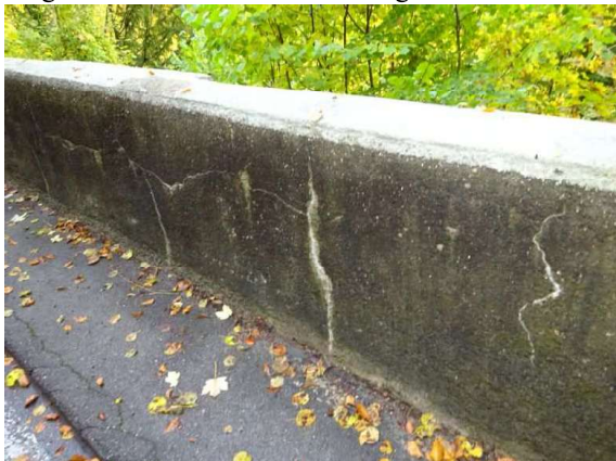
HP2021_BRÜSTUNG RISSE MIT AUSSINTERUNGEN
