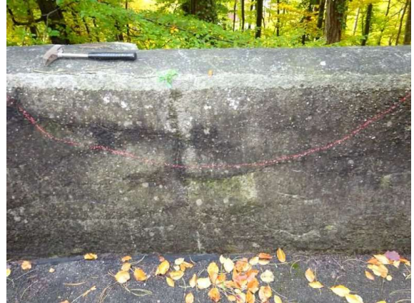
HP2021_BRÜSTUNG GERISSEN UND HOHLKLINGEND
