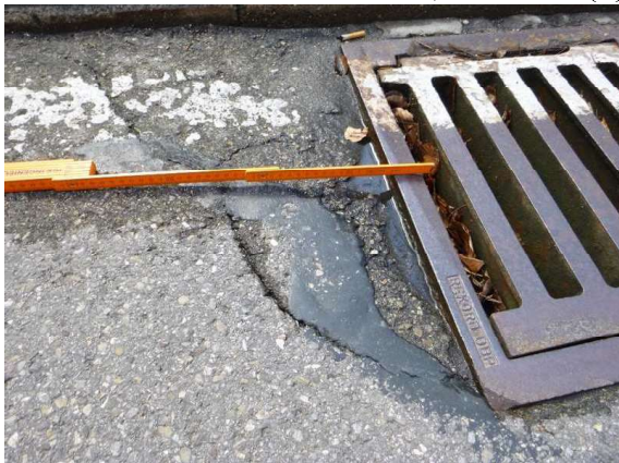
7524526_2016H_18-BELAG BEI STRAßENABLAUF ABGESACKT
