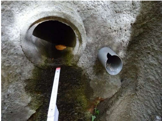
HP2021_ENTWÄSSERUNGSROHR ZU KURZ
