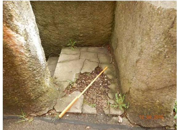
7524526_2016H_10-AUSBRUCHSTELLE PODEST TREPPE VORN
