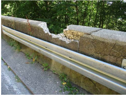
Abbildung 6: Steinschlagschaden vom Juli 2022
